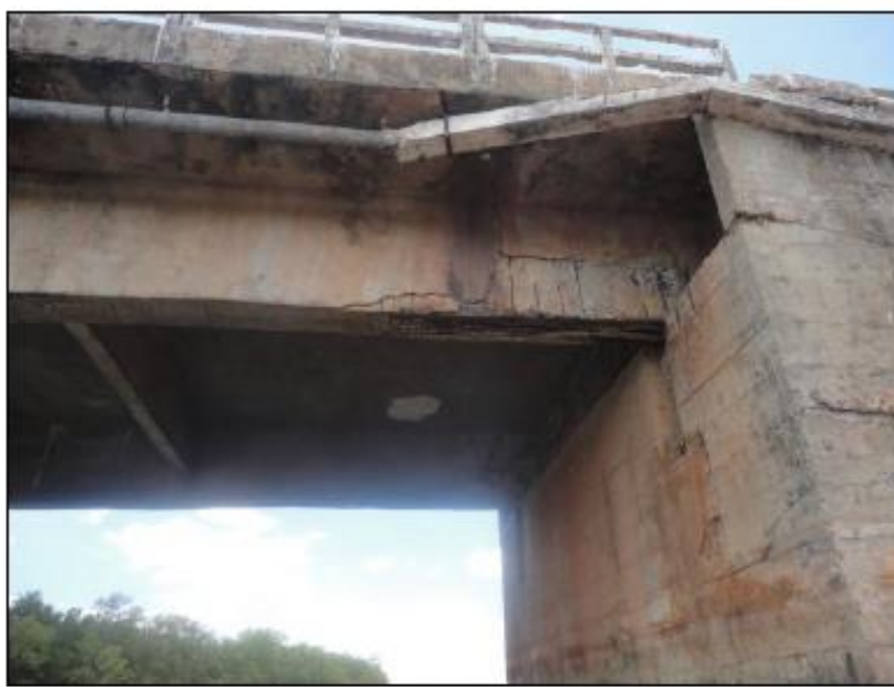
Foto 4 – Situação modelo de ponte com estrutura danificada
