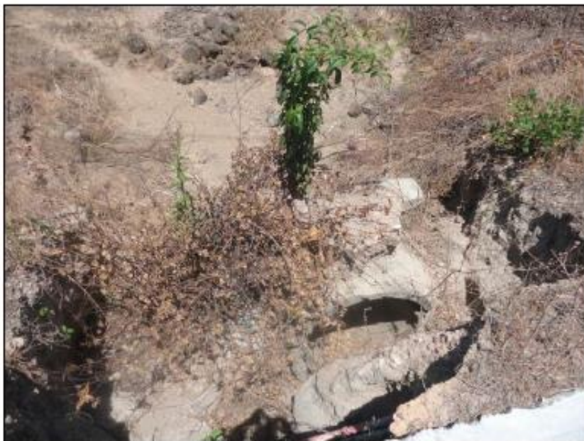
Foto 3 – Situação modelo de bueiro danificado
