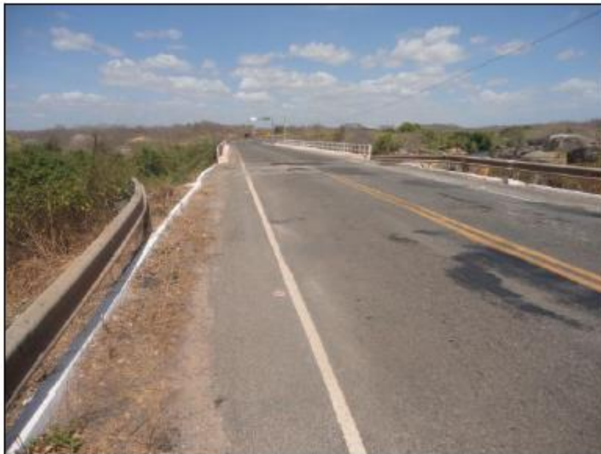
Foto 1 – Situação modelo de defeito no asfalto
