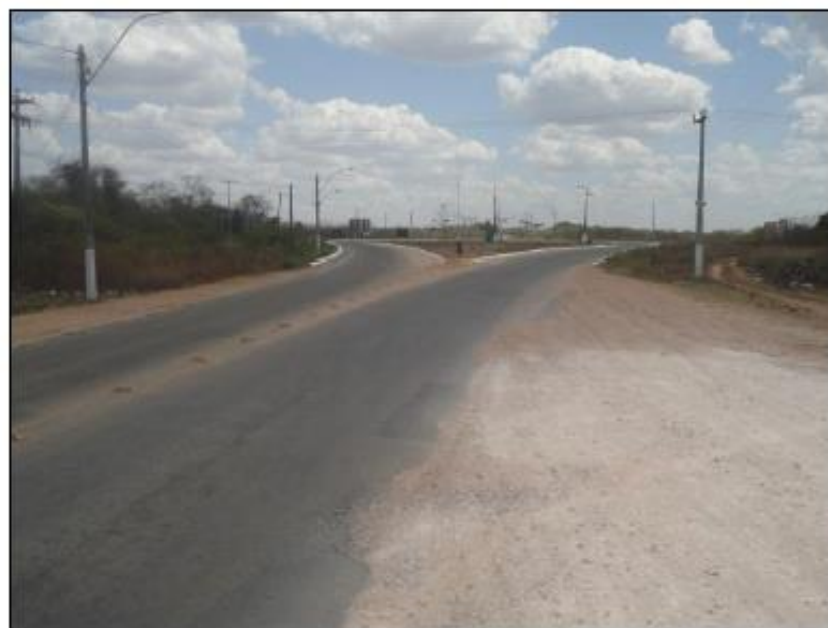
Foto 2 – Situação modelo de acostamento danificado
