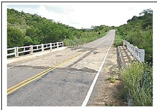
Est. 172+1,90: Ponte sobre o rio Massapé com vão de 11,00 m. Matas ciliares preservadas.
