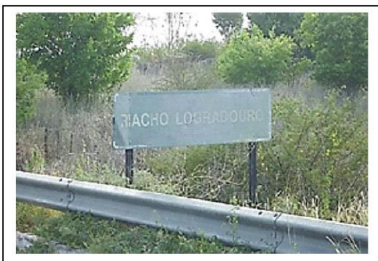
Est. 888+1,50: Placa da ponte sobre o rio Logradouro necessitando de substituição e/ou pintura. Observe-se a vegetação ciliar mista
