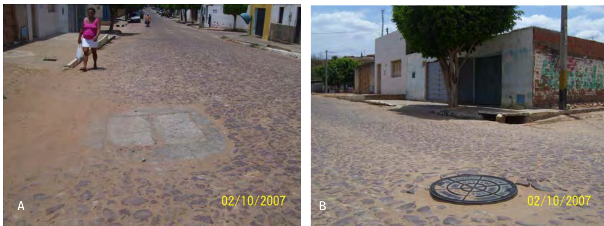
Foto 15: Rede coletora de esgotos existente na cidade de Barbalha – CE.
